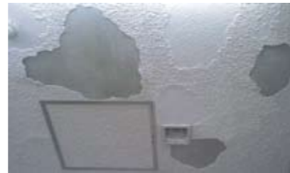
広範囲に渡り剥がれた図書館の天井雨漏りもかなりひどい状況である
